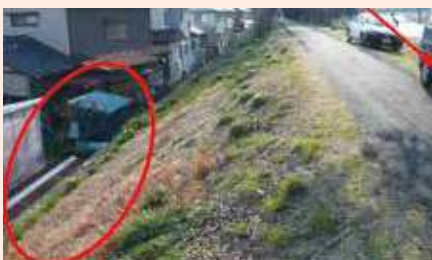
平成26年台風18号 あかつき大橋上流右岸漏水状
