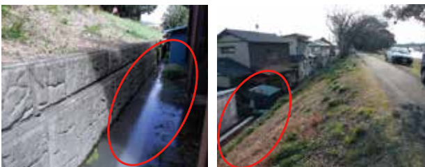
平成26年台風18号あかつき大橋上流右岸漏水状況 漏水箇所
